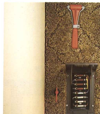
Sicherungskasten, Hauptschalter für Wohnraumelektrik.
