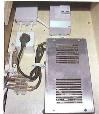
Ladegerät und Sicherungsautomat.
